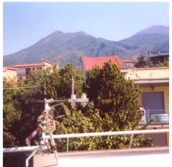
Figura 8. Detección de la radiación global mediante radiómetro instalado en la terraza del ISAFOM-CNR, Nápoles.
